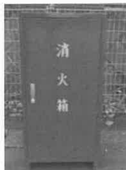
初期消火箱 (固定式)
